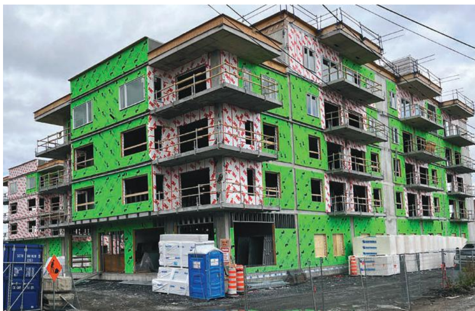
Des condos sont en construction pour contenter la demande. (Photo : Julien Dubois)
