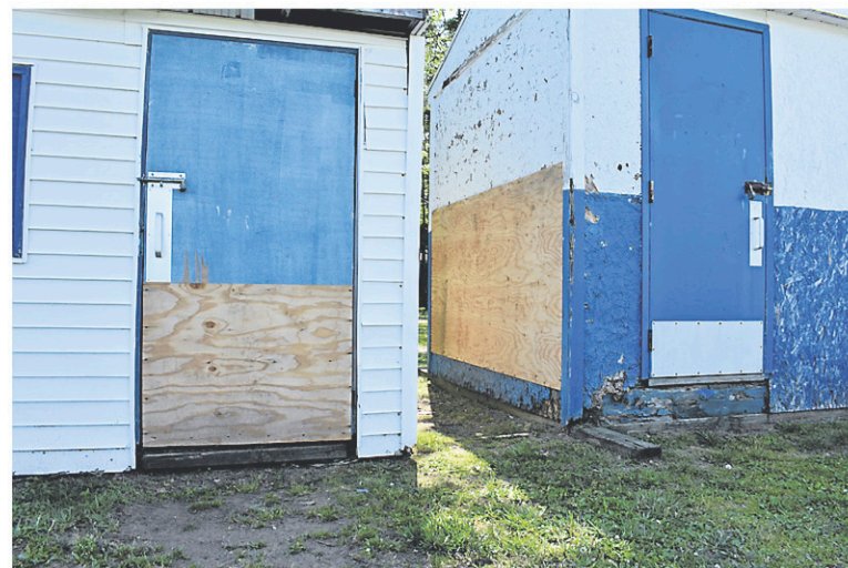
De sérieux dommages ont été causés sur ces bâtiments du parc Isabeau dans le secteur Trois-Rivières.
