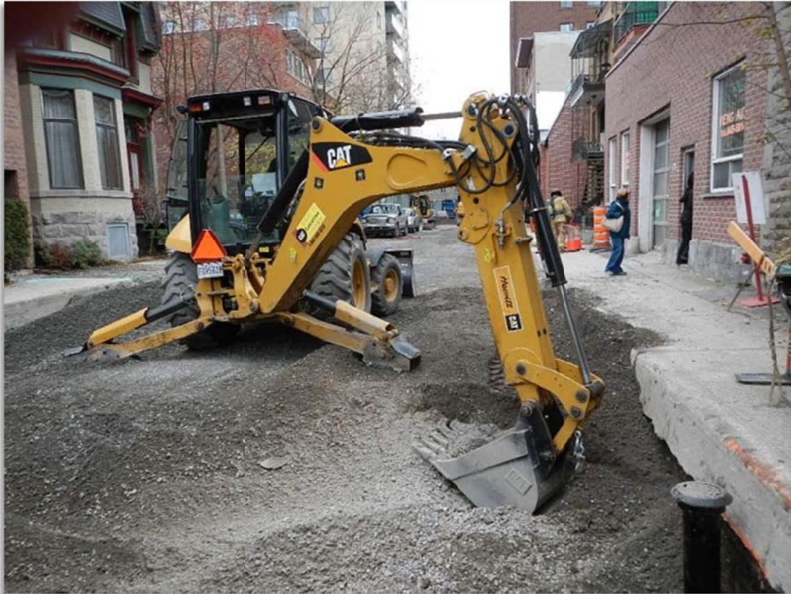
Figure 10 : Pelle mécanique responsable du bris
