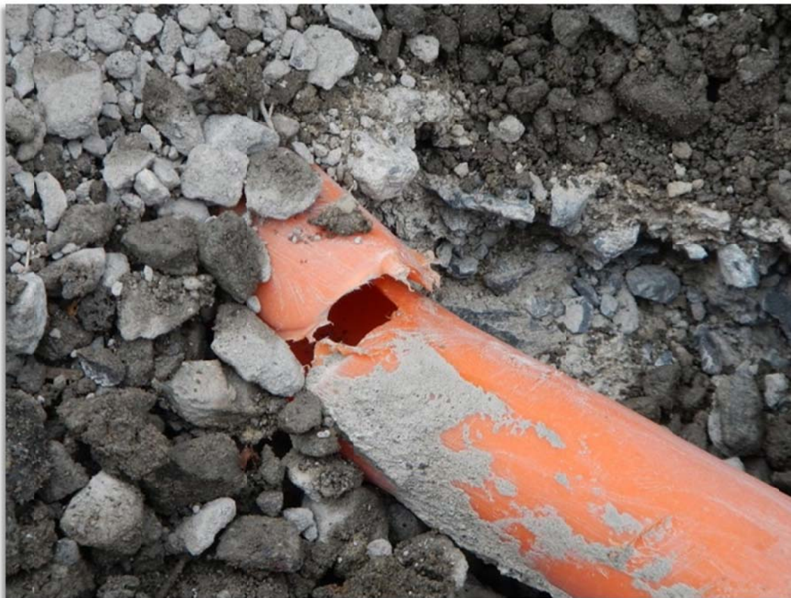
Figure 11 : Conduite de gaz touchée
