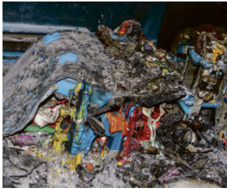
L'incendie a ravagé la chambre du garçon. (Photo: Pascal Cournoyer)
