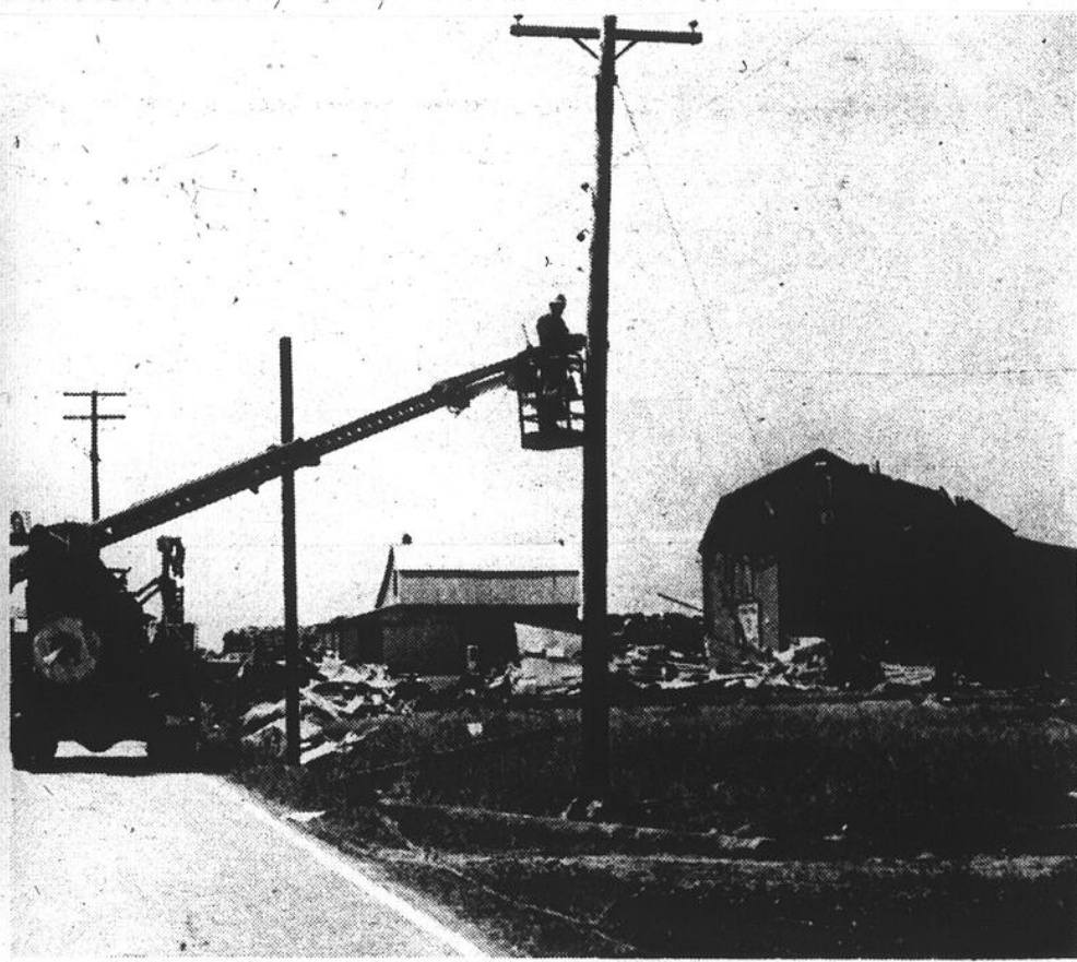
Techniciens de l'Hydro-Québec et de Bell Canada en ont pour plusieurs jours à rétablir le service complet.
