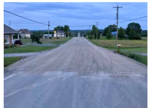
Rang 3 Sud, en direction du Lac Fortin : décohésionnement complété
