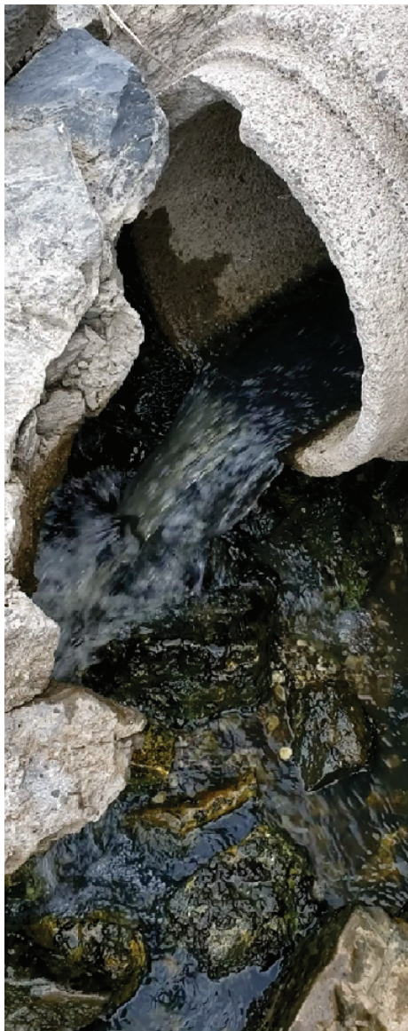
Sortie du trop-plein du bassin contenant l'eau de lavage
