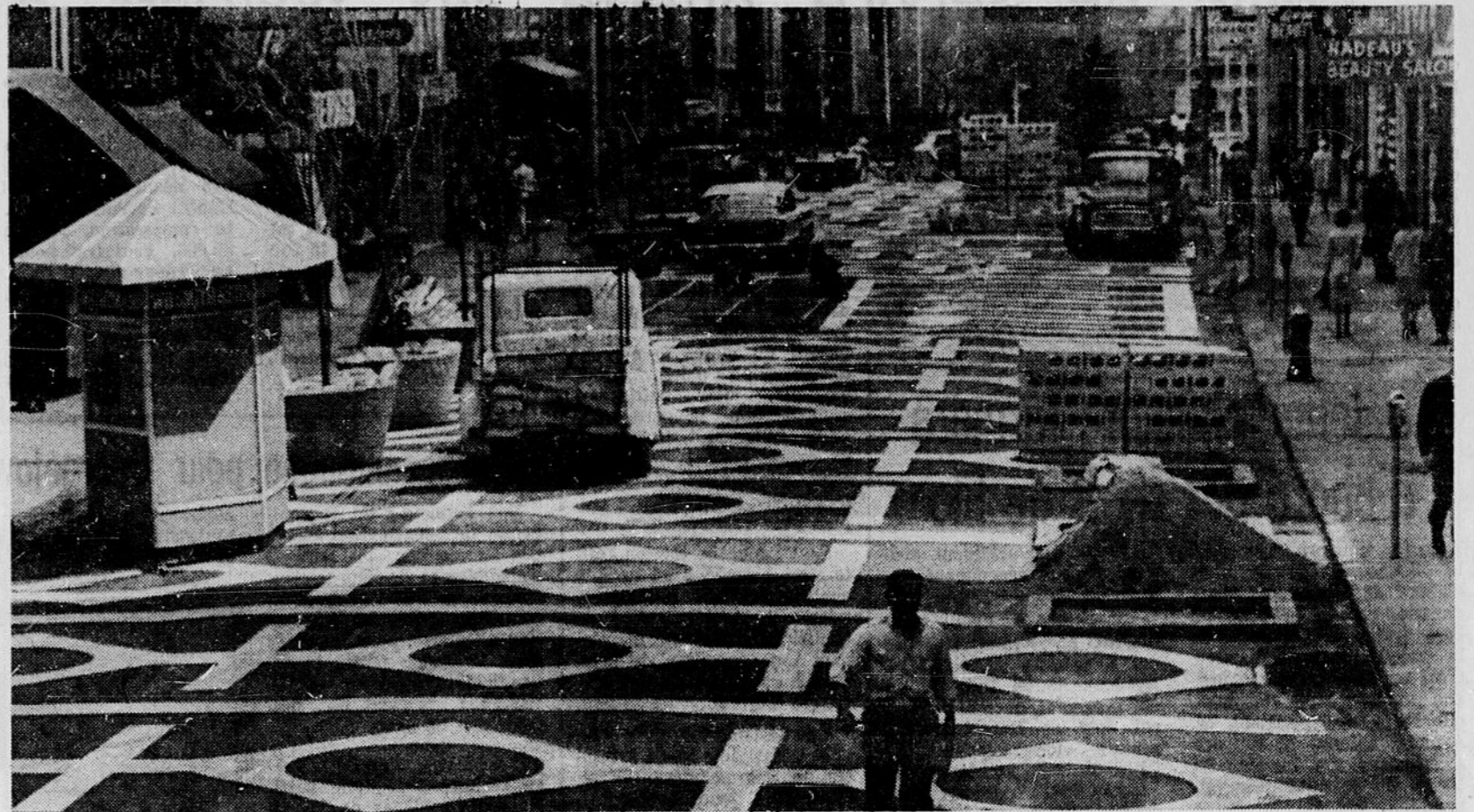
DESSINS MODERNES SUR LE PAVE DU MAIL — Les ouvriers de dessins modernes. Le pavillon de renseignements touristiques, exécutent les travaux du mail de la rue Sparks, sur un pavé décoré à gauche dans la photo, sera installé au centre de la rue. (Photo Champlain Marcil)
