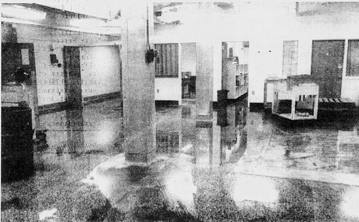
EAU - Plusieurs résidences ont eu la visite de l'eau dans leur sous-sol. Ici, c'est l'Hôpital de Chicoutimi qui a eu la surprise de voir l'eau apparaître dans le sous-sol. Aucun malade n'a été incommodé cependant.
