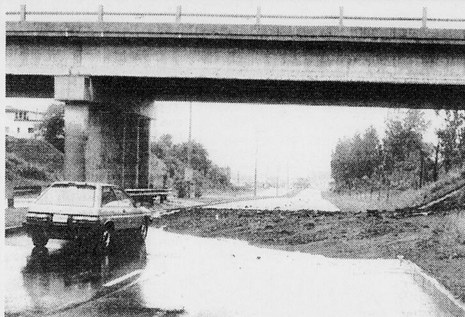
VIADUC - Cet automobiliste a eu la surprise de sa vie, hier, rue Saint-Henri, au-dessus du boul. Saint-Paul, quand il a vu qu'il était impossible de passer, l'eau ayant obstrué complètement le passage.
