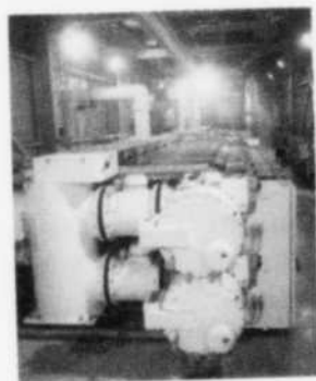
■ Le système de réception de l'électricité est intérieur, une première pour Alcan.
