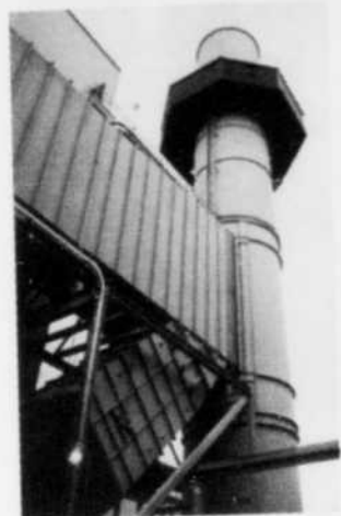
■ Surplombant le centre d'électrolyse, l'une des trois cheminées du centre de traitement des gaz.
