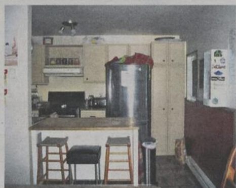
L'ancienne cuisine du Centre Le Diapason a complètement été détruite et refaite.
