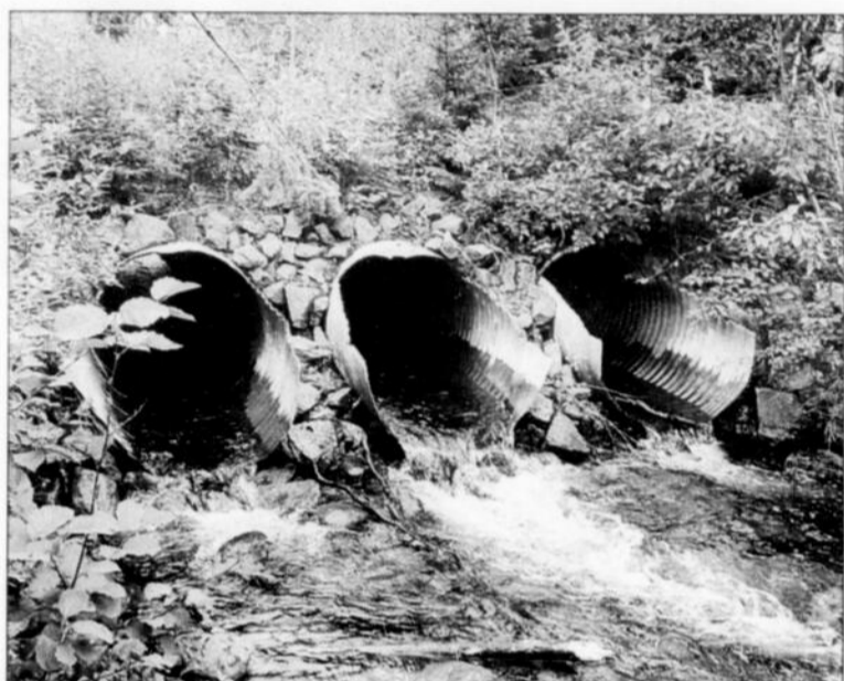
À L'Anse-Saint-Jean, le ministère procédera à des travaux d'analyse de capacité d'évacuation des volumes d'eau du ponceau du ruisseau Patrice-Fortin.
