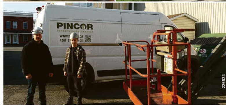
Type de protection que nous utilisons entre autres dans les travaux d'hôpitaux (Saint-Jean-sur-Richelieu)
