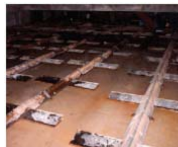
Pousseur de type «push floor» Source : Biomasscenter www.biomasscenter.org
