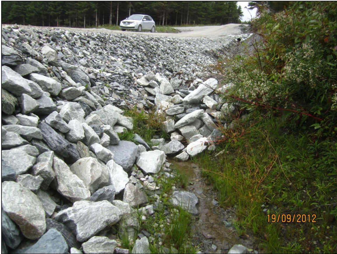
Figure 10 Présence d'une barrière rocheuse dans un fossé de drainage
