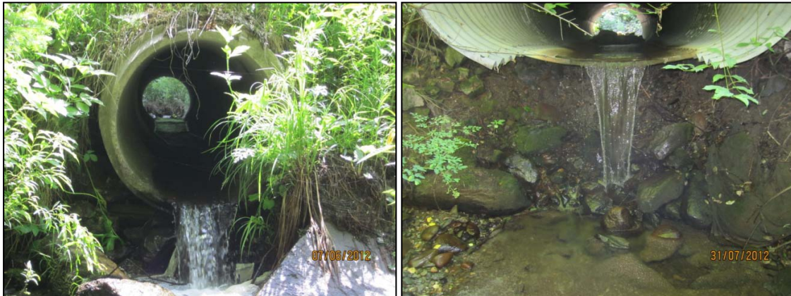
Figure 4 Chutes causant l'affouillement du lit du cours d'eau
