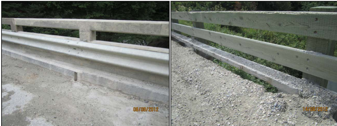
Figure 11 Comparaison des ponts avec présence et absence de chasse-roues
