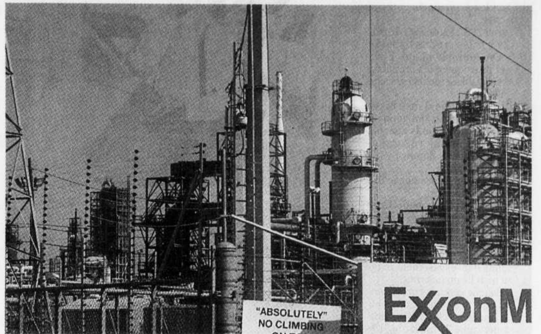
Une raffinerie d'Exxon Mobil, au Texas. La plupart des raffineries touchées par l'ouragan Ike ont pu rapidement reprendre la production. Le marché du pétrole a été plus touché par la chute de Lehman Brothers que par le passage de la tempête.
