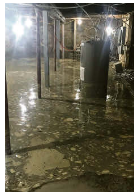
De l'eau s'est encore infiltrée au sous-sol du restaurant Le Fougasse en raison d'un bris d'aqueduc. Photo tirée de Facebook
