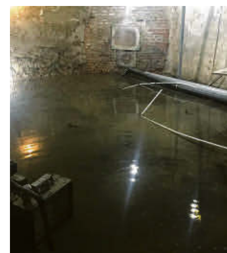
Cette fois, 16 pouces d'eau se sont retrouvés dans le sous-sol du restaurant Le Fougasse en raison du bris de canalisation. Photo tirée de Facebook
