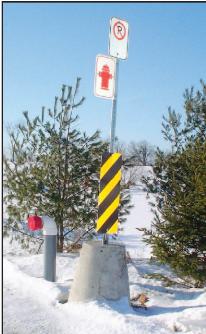
Une des nouvelles bornes sèches installées depuis 2005.
