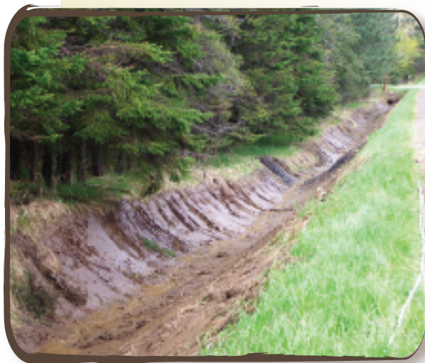
Figure 9 Nettoyage d'un fossé avec un godet de dimension inappropriée 16
