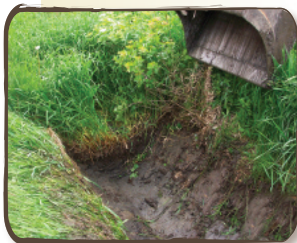
Figure 4 Fossé de pente 3 % Nettoyage par la méthode du tiers inférieur
