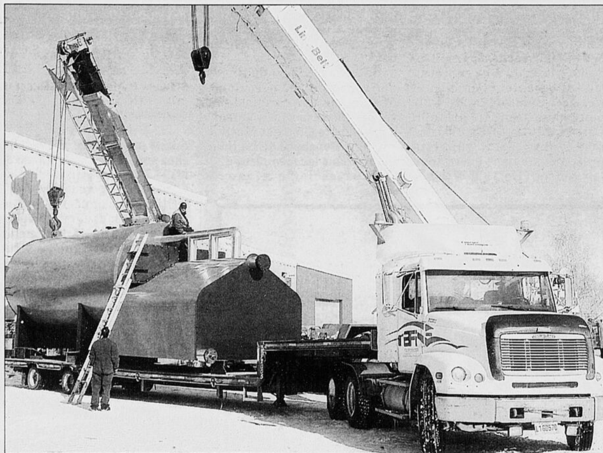
Une des deux immenses cuves, dont le poids atteint quelque 80 000 livres, qui deviendront le cœur d'une centrale d'énergie thermique à haute valeur environnementale dans l'État de New York.
