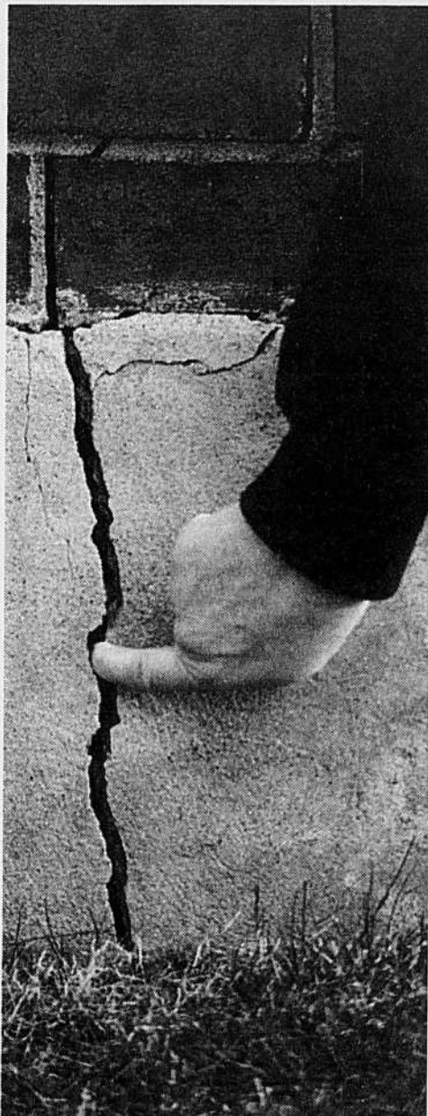
Le gonflement de la pyrite cause d'importantes fissures, comme en fait foi la photo d'une portion du mur du garage de M. Saint-Pierre
