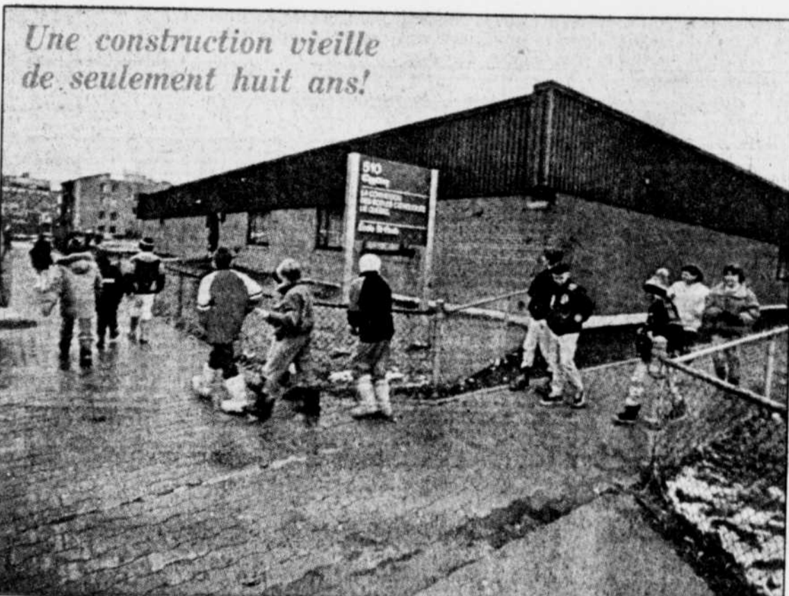
Une construction vieille de seulement huit ans! L'école a été construite sur une dalle flottante posée sur du sable compacté. Or, cette dalle ne repose sur aucun pieu, ce qui occasionne des mouvements de la structure... un affaissement de trois quarts de pouce en huit ans. Des murs qui se fissurent, des portes qui ne ferment plus, des blocs de béton qui se détachent, etc.
