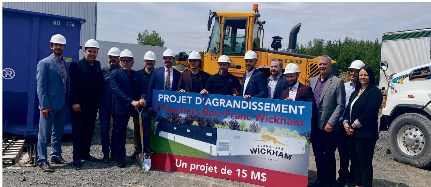
Les gestionnaires et les partenaires de l'entreprise étaient présents lors de la pelletée de terre officielle qui a eu lieu le 14 juin sur le terrain en construction de Planchers Bois Franc Wickham. Photo Sarah Villemaire | La Pensée ©
