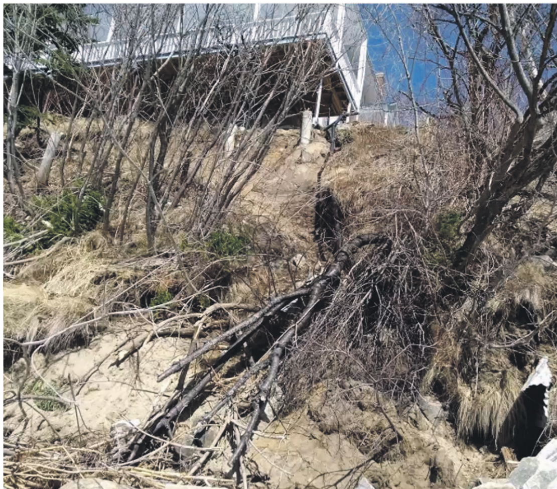
Voici l'érosion observée sous la maison Dufferin, un secteur critique, selon le spécialiste en génie côtier, Yann Ropars. Photo : powerpoint
