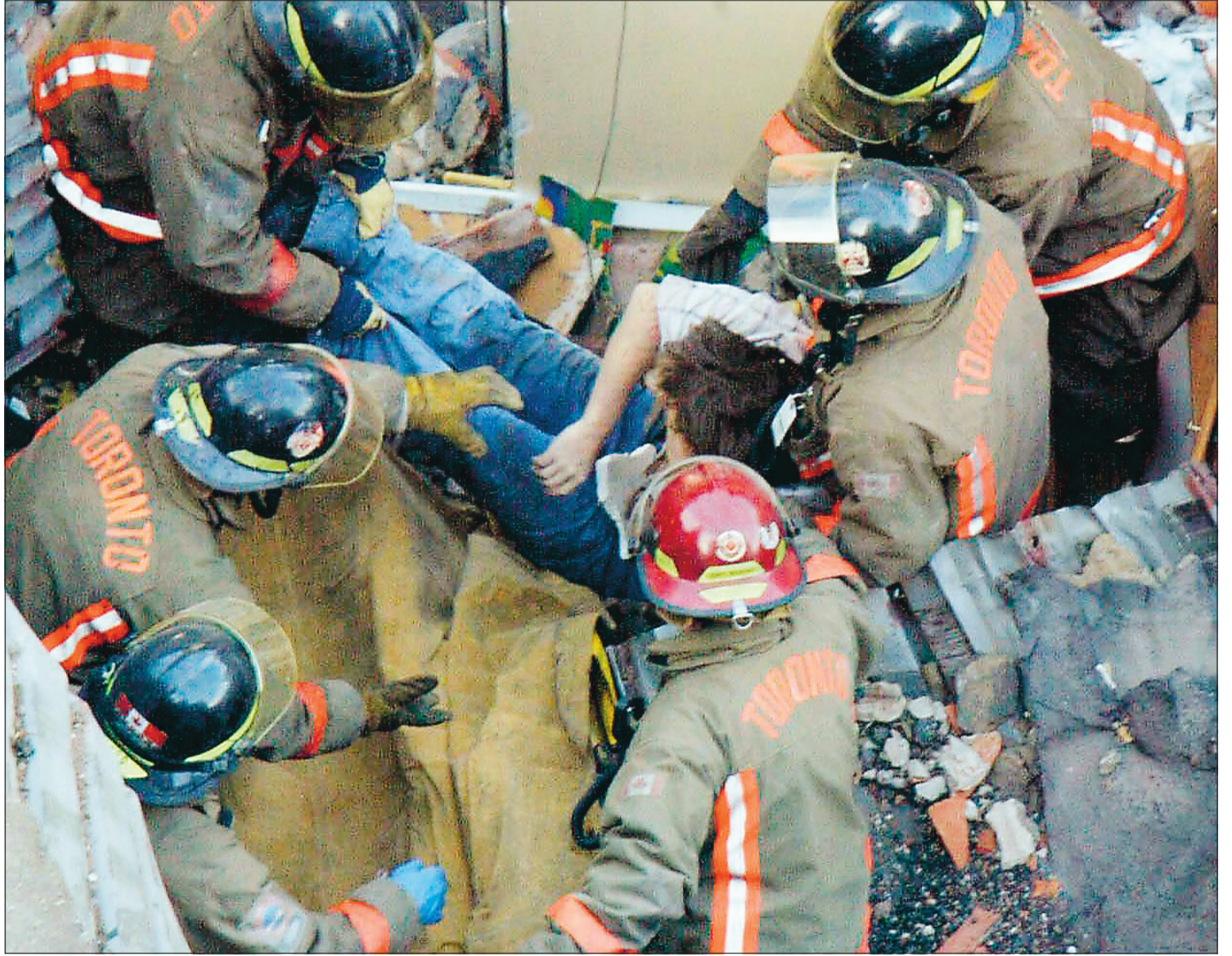
Un vieux théâtre en démolition s'est écroulé en partie hier sur une école voisine dans le centre de Toronto, faisant un mort et 14 blessés. Pompiers et secouristes ont passé la journée à dégager les blessés des décombres. À lire en page A5.
