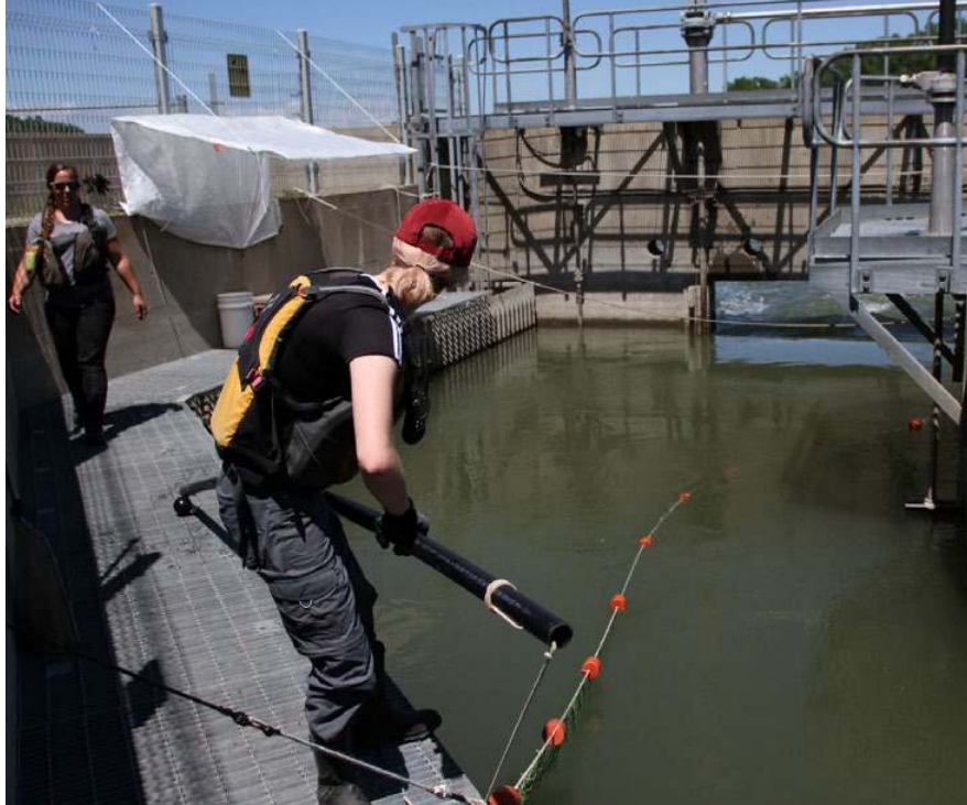
Travaux de réfection de la passe migratoire Vianney-Legendre, 2018. Crédit photo : Parcs Canada.
