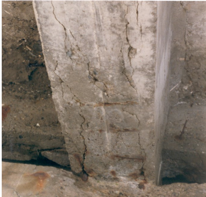
Photo 4.2-3 a) – Délaminage du dessous d'une poutre
