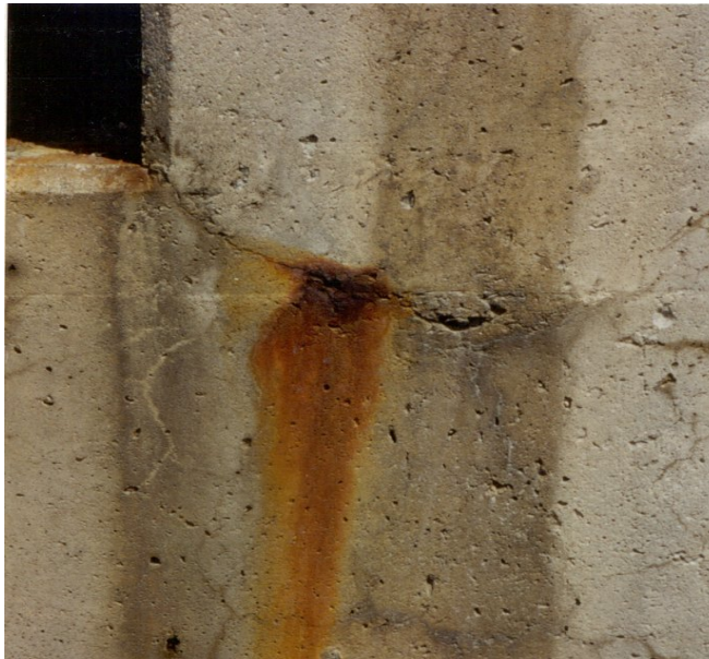
Photo 4.2-2 a) – Tache de rouille à la surface du béton Corrosion moyenne de l'armature
