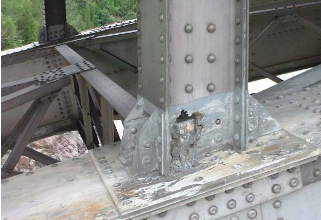
Photo 4.5-1 d) – Corrosion très importante et perforation de l'aluminium
