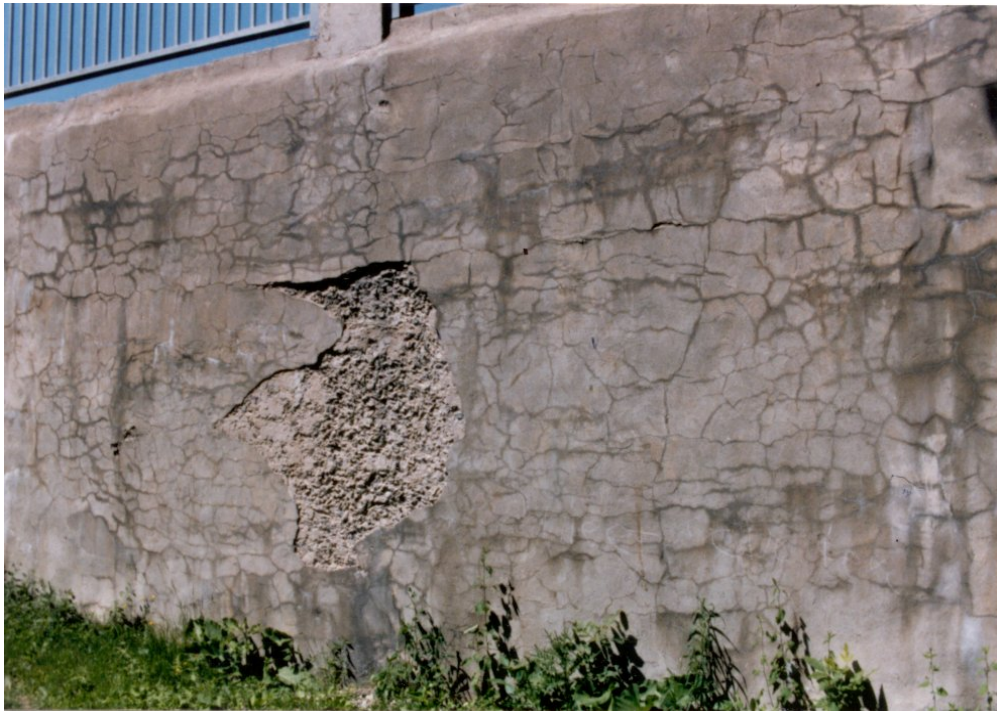
Photo 4.2-1 a) – Désagrégation moyenne d'un mur de soutènement
