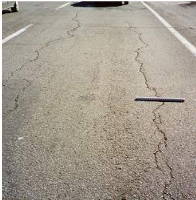
Photo 4.7-1 b) – Fissure longitudinale dans l'enrobé
