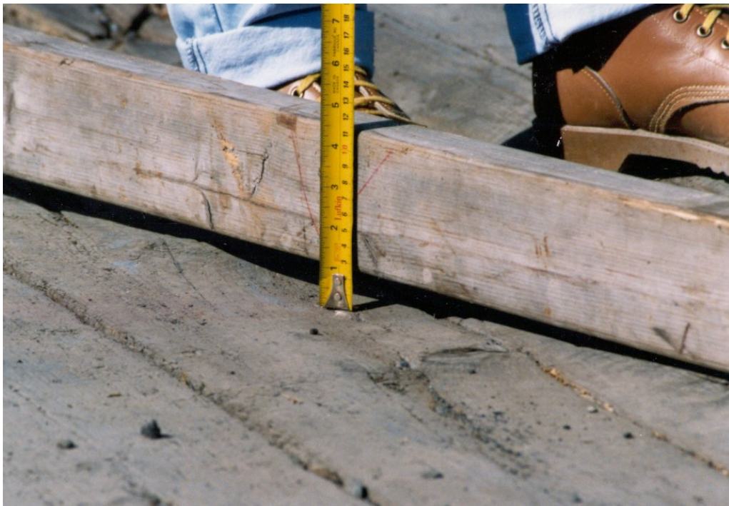
Photo 4.6-2 b) – Usure très importante d'un platelage en bois
