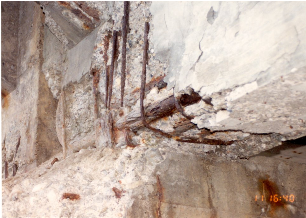
Photo 4.2-2 d) – Corrosion très importante de l'armature et barres sectionnées
