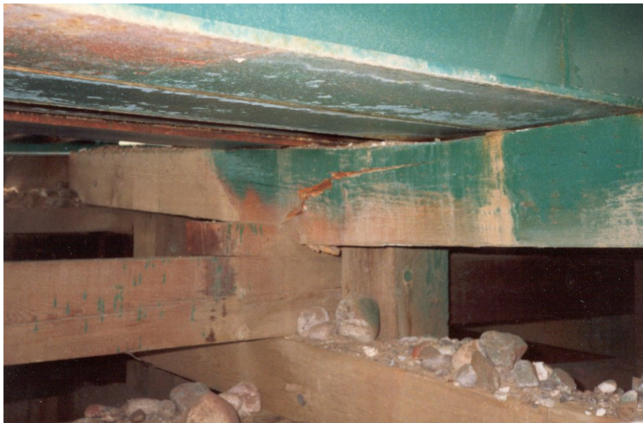
Photo 4.6-4 b) – Rupture d'une pièce
