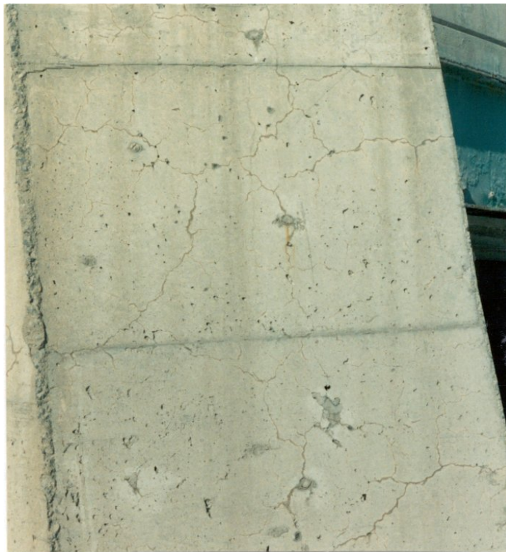
Photo 4.2-5 a) – Fissures en forme de réseau
