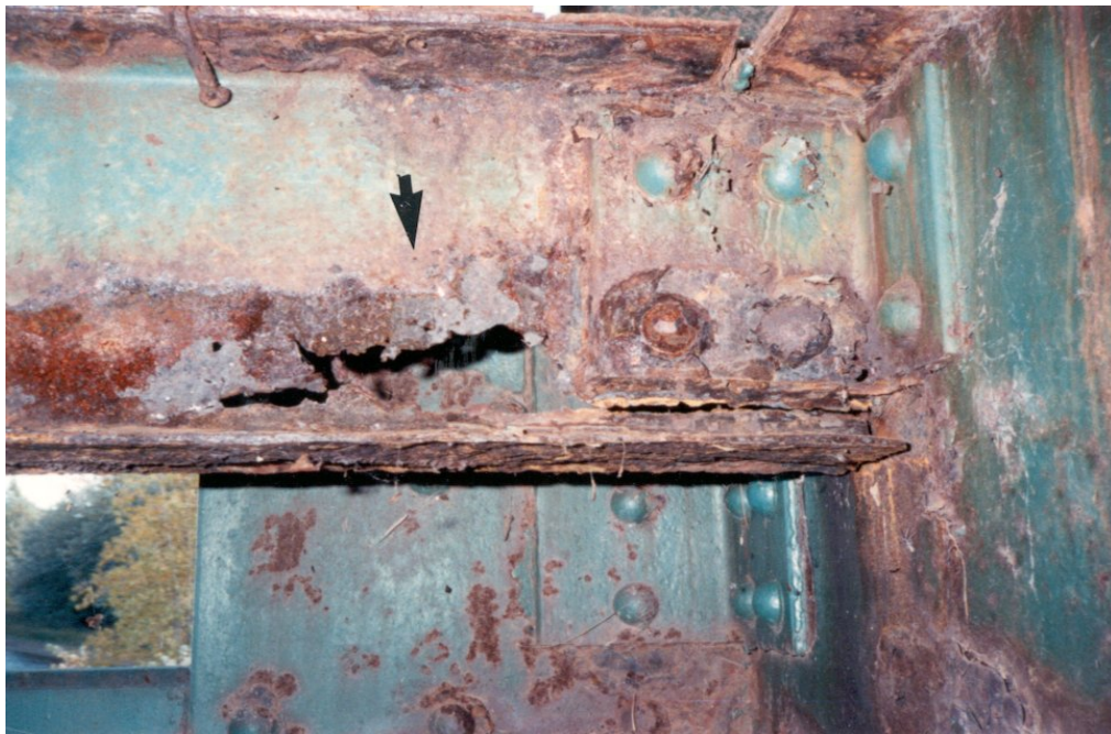
Photo 4.4-1 c) – Corrosion très importante d'un longeron
