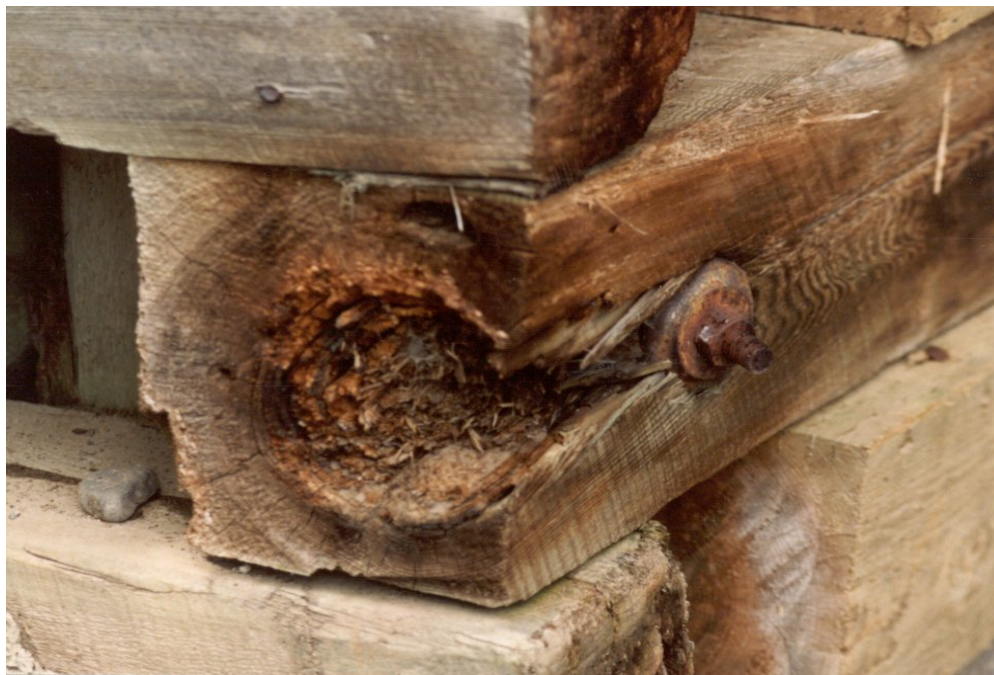
Photo 4.6-1 c) – Pourriture importante de l'extrémité d'une pièce
