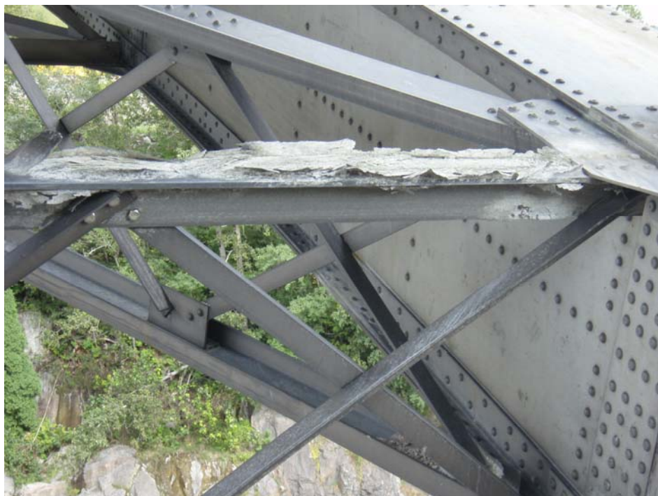
Photo 4.5-1 c) – Corrosion importante de l'aluminium
