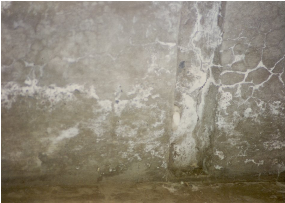
Photo 4.2-7 a) – Efflorescence sous une dalle
