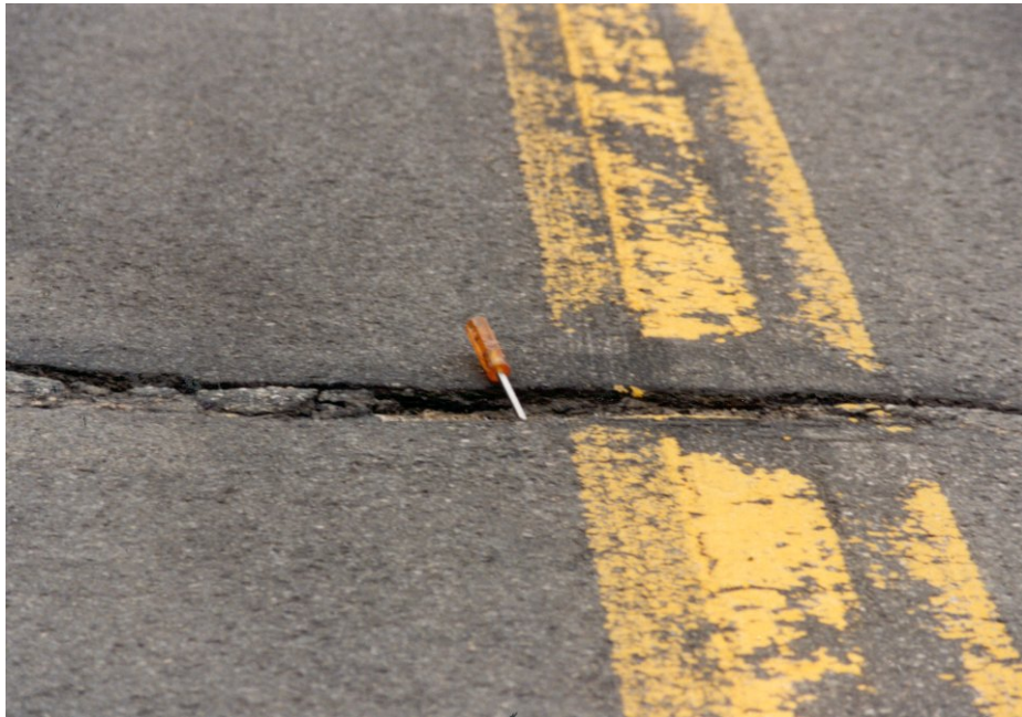
Photo 4.7-1 a) – Fissure transversale dans l'enrobé
