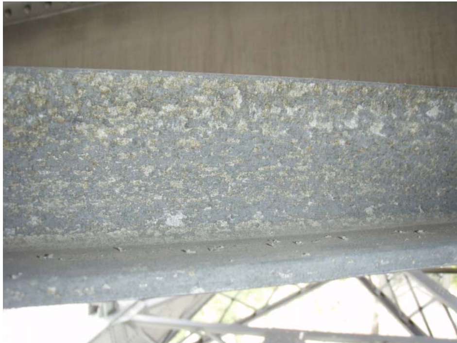
Photo 4.5-1 b) – Corrosion moyenne de l'aluminium
