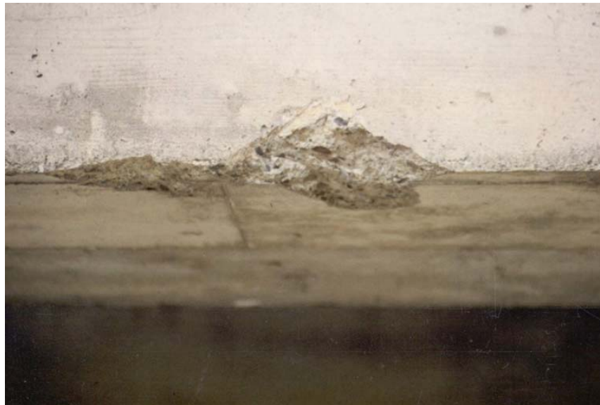
Photo 4.2-4 a) – Éclatement du béton dû à un impact
