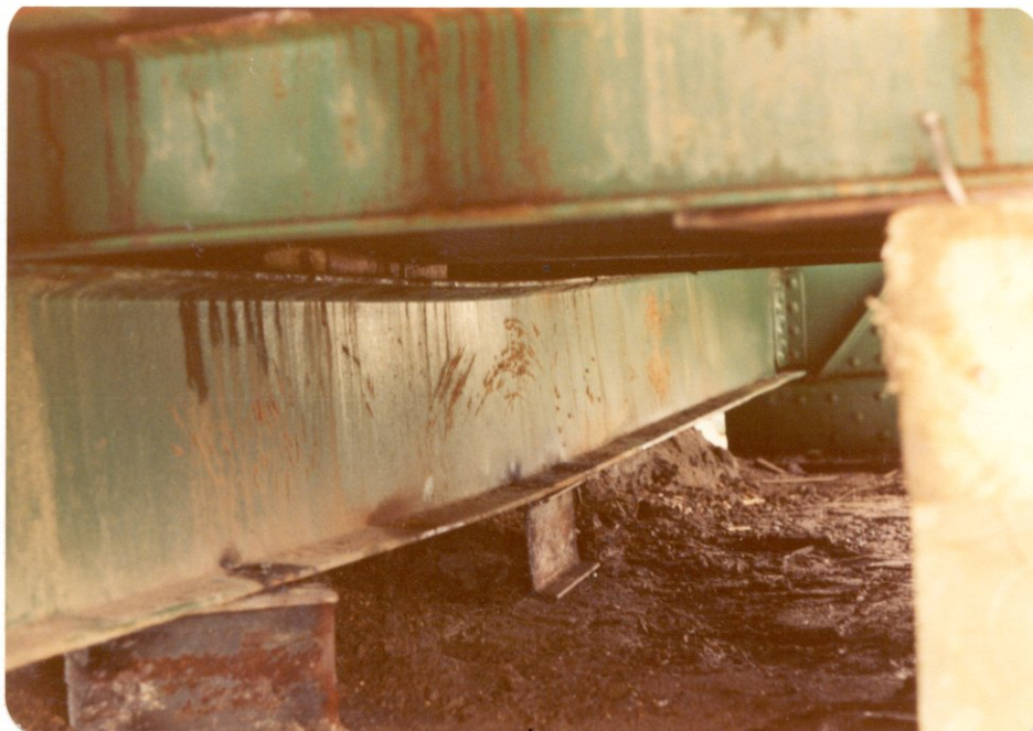
Photo 4.4-3 b) – Fléchissement d'une entretoise
