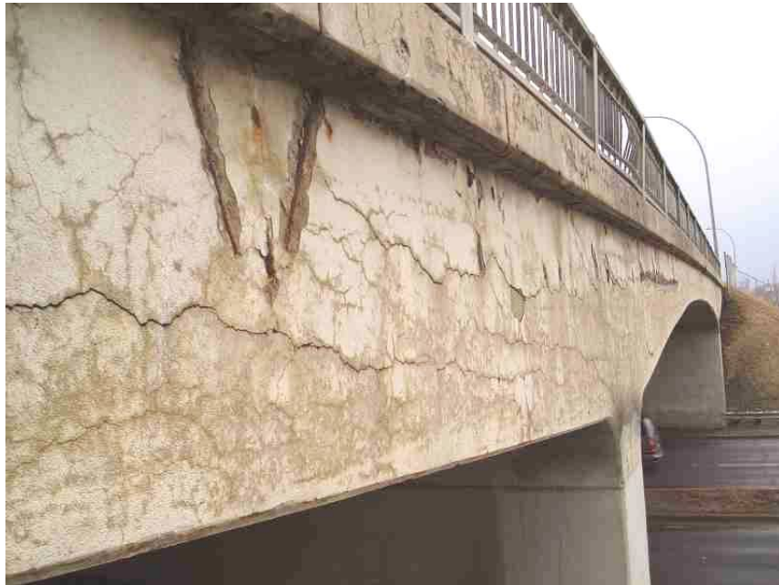
Photo 4.2-5 b) – Fissures causées par la réaction alcali-granulat
