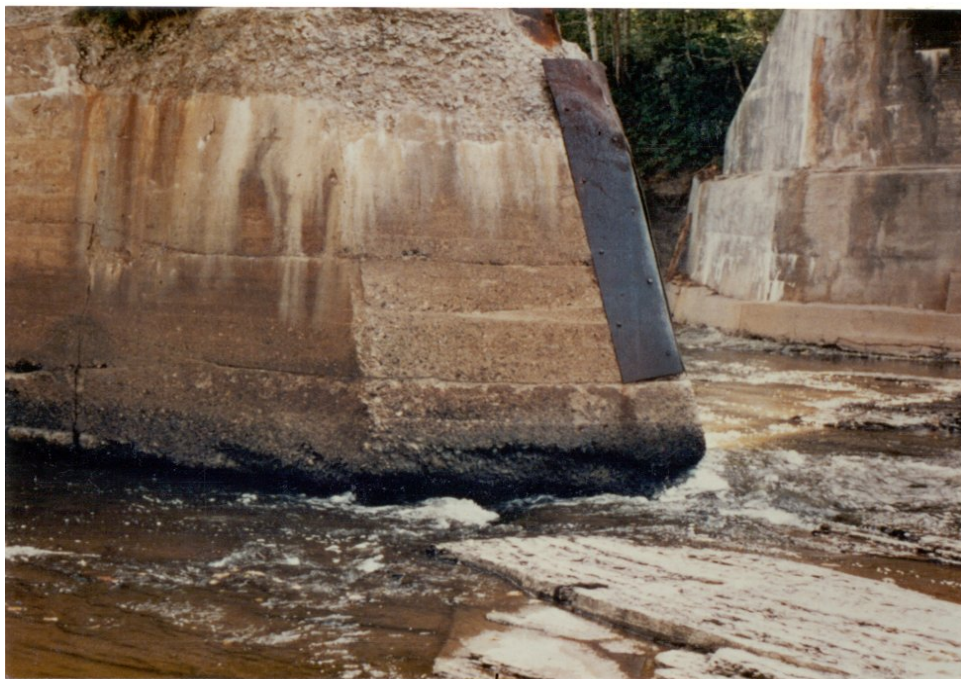
Photo 4.2-1 d) – Érosion très importante de la semelle d'une pile
