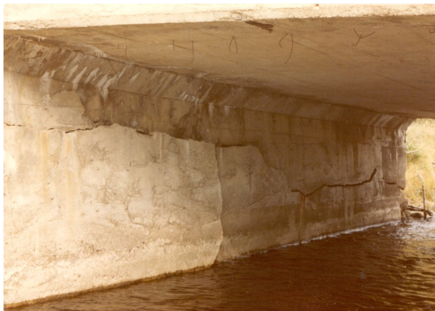
Photo 4.2-5 c) – Fissures causées par des tassements différentiels
