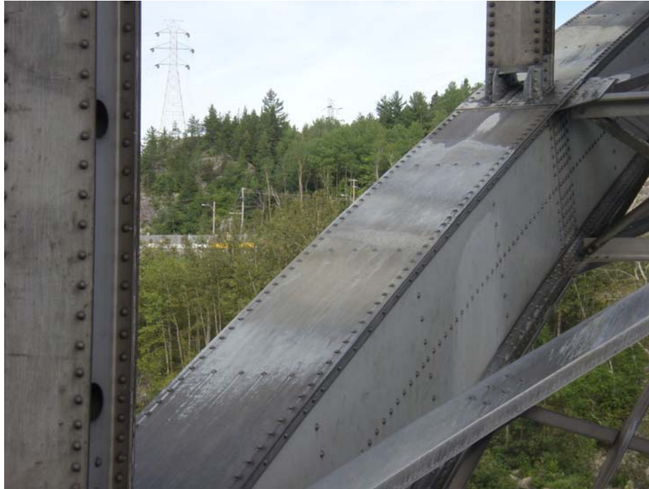
Photo 4.5-1 a) – Corrosion légère de l'aluminium
