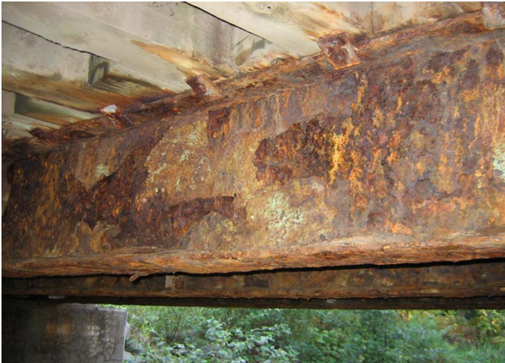
Photo 4.4-1 b) – Corrosion importante d'une poutre à âme pleine
