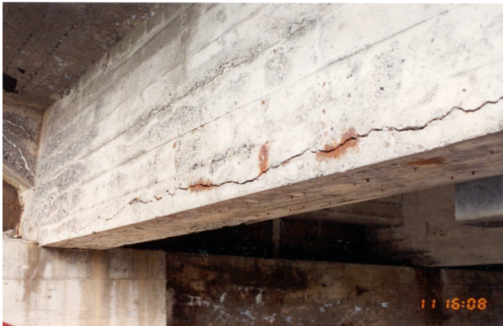
Photo 4.2-3 b) – Délaminage du dessous d'une poutre
