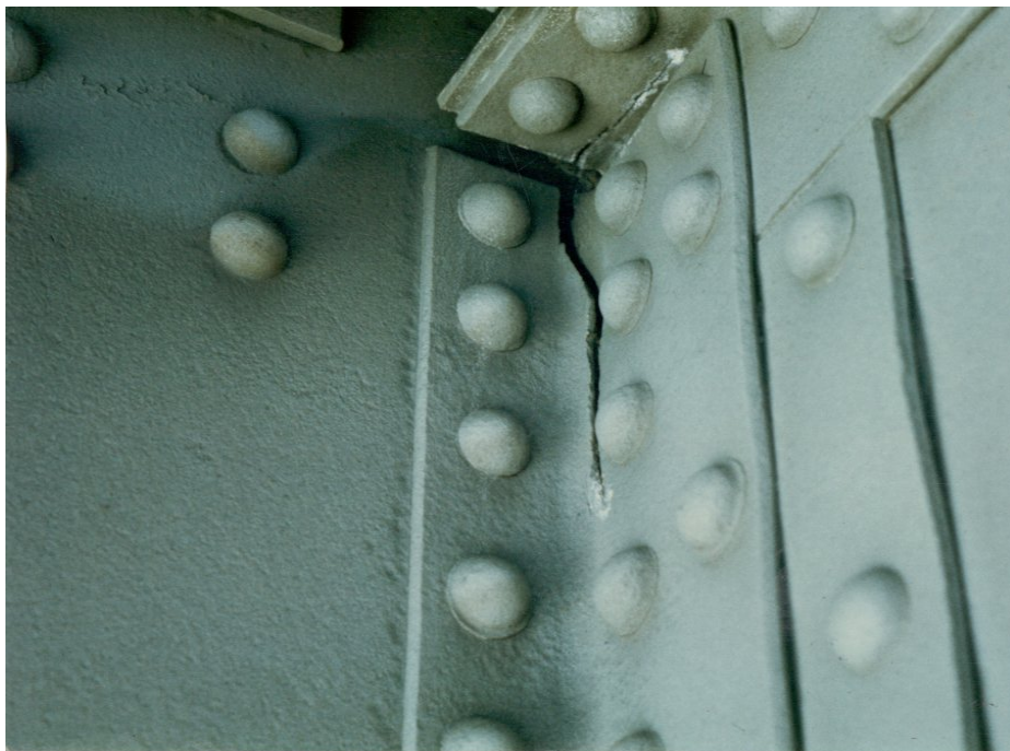
Photo 4.4-2 b) – Fissure dans un assemblage riveté
