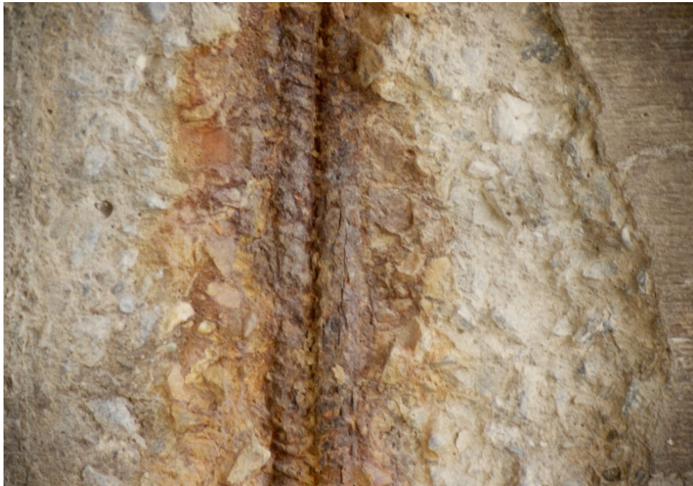
Photo 4.2-2 b) – Armature apparente rouillée, mais diminution de section négligeable Corrosion moyenne de l'armature
