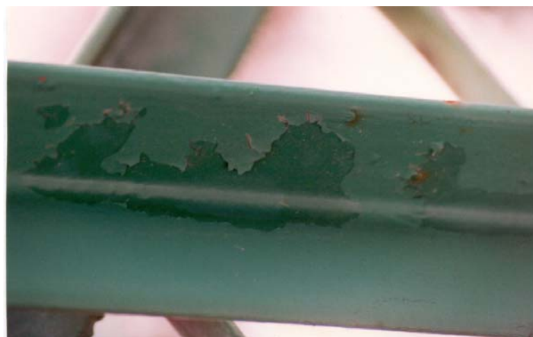
Photo 10.3-3 Pelage et délaminage
