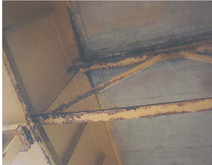
Photo 10.3-1 Peinture absente ou corrosion sous le feuillet
