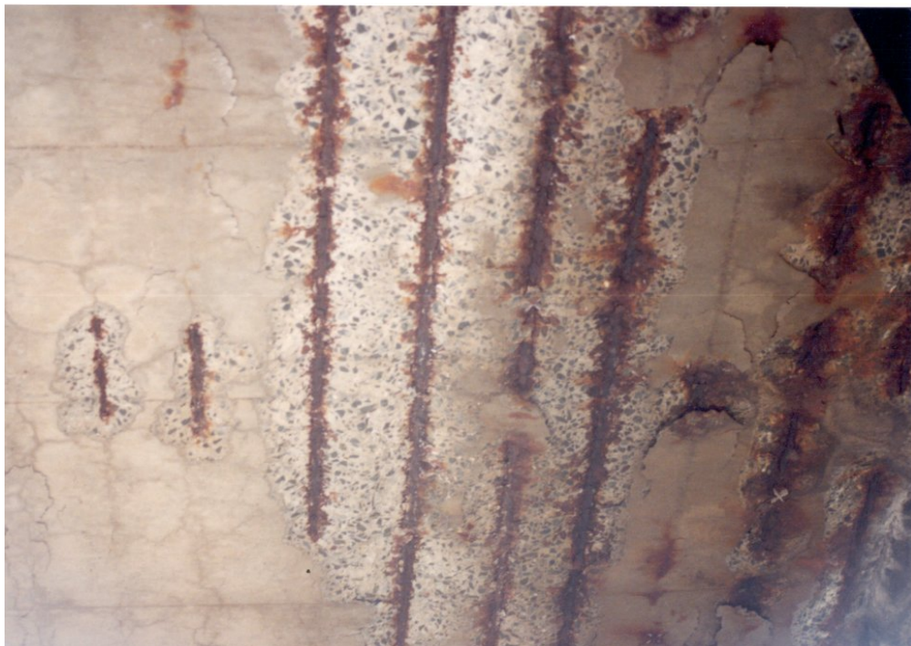
Photo 4.2-2 c) – Armature apparente rouillée et diminution de section \leq 30\% Corrosion importante de l'armature
