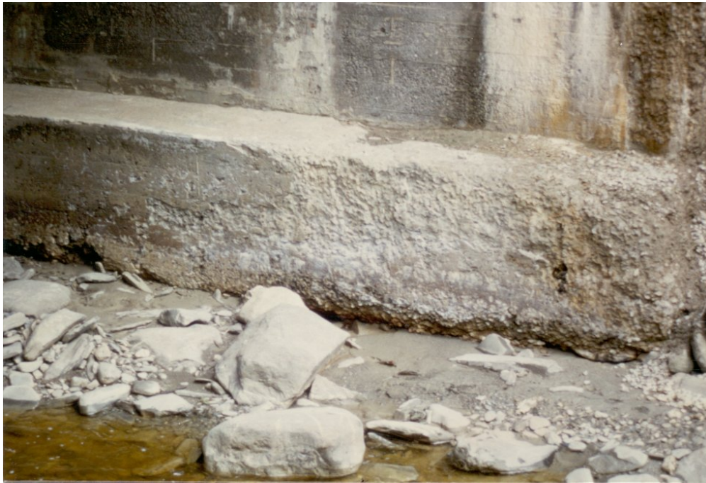
Photo 4.2-1 c) – Érosion légère de la semelle d'une pile
