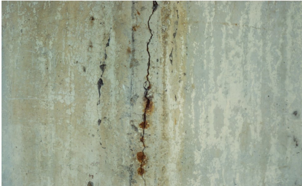
Photo 4.2-5 d) – Fissures causées par la corrosion de l'armature
