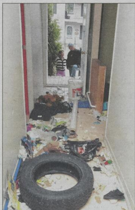
Le propriétaire a rempli 17 sacs de déchets seulement que pour se faire un chemin dans le passage.
