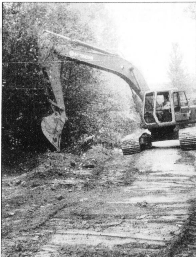
TRAVAUX - Les dégâts aux ponts, ponceaux et chemins s'élèvent à environ 140 000 $. Déjà la machinerie lourde est en action.
