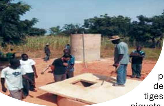
Figure 5. Puits maraîcher avec un château d'eau pour irrigation goutte à goutte
