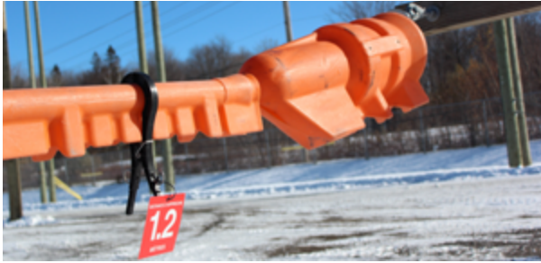
Protecteurs correctement installés
