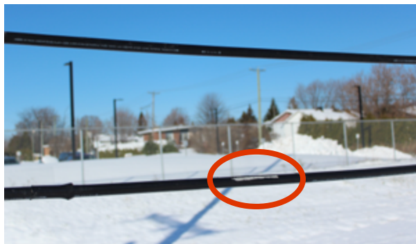
Gaine de conducteur endommagée
