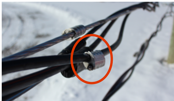
Protecteur manquant sur la connexion
