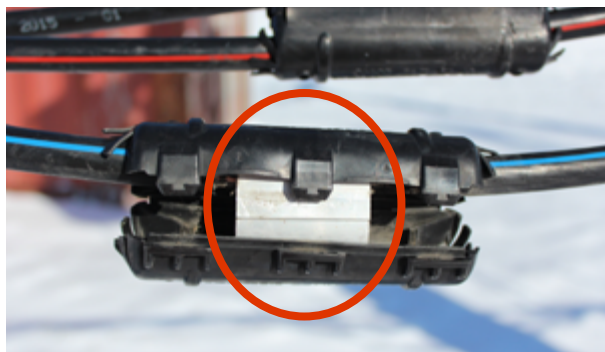
Protecteur ouvert ou endommagé
