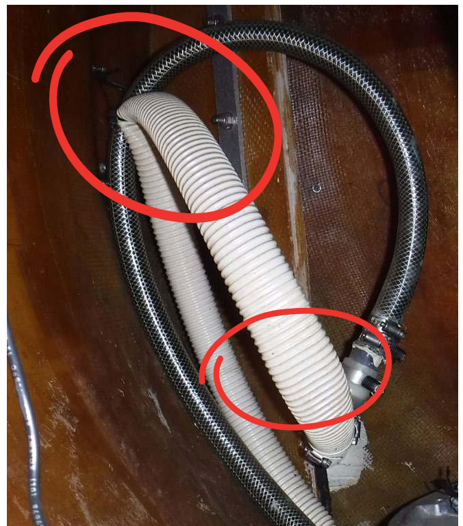
Problème avec un tuyau.
