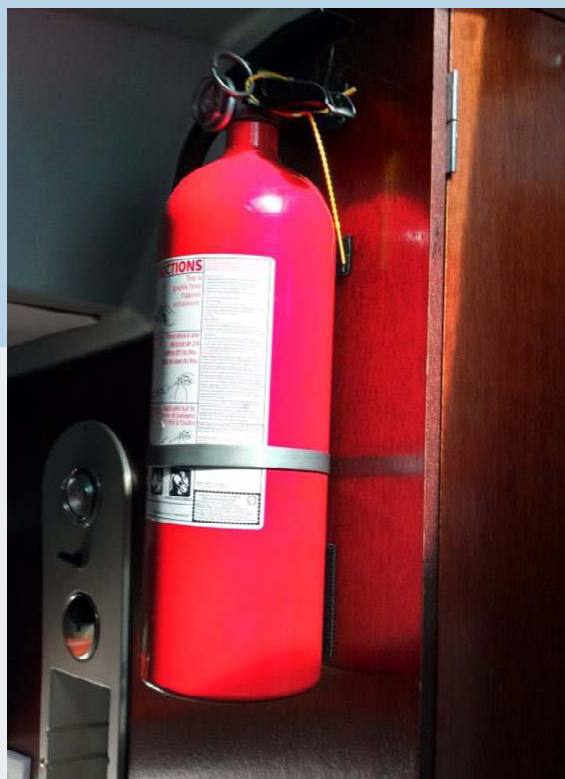
Extincteur. Crédit photo : Formation Nautique Québec.
