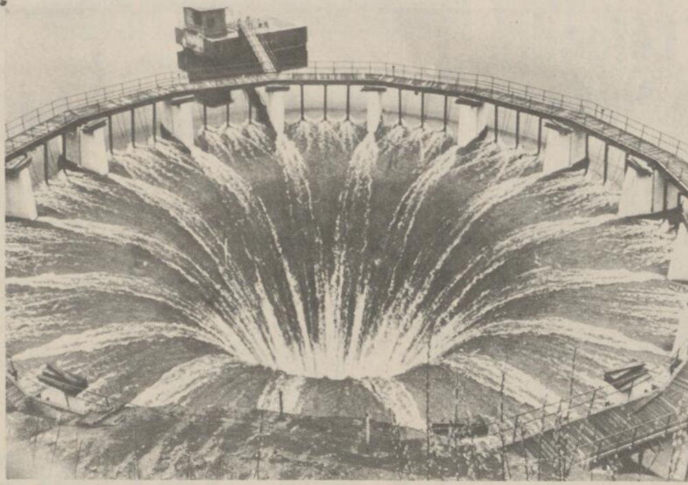
GLORY HOLE --- La fonte des neiges et des pluies abondantes ont fait déborder rivières et ruisseaux, en Nouvelle-Angleterre. A Whitingham, dans le sud du Vermont, pour la première fois depuis dix ans, les flots ont enjambé le barrage Hariman pour s'engouffrer dans le "Trou de gloire" et former une corolle impressionnante.
