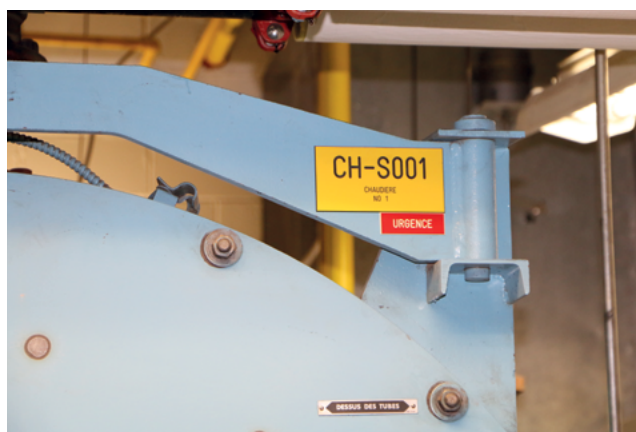
Exemple d'identification de l'appareillage
