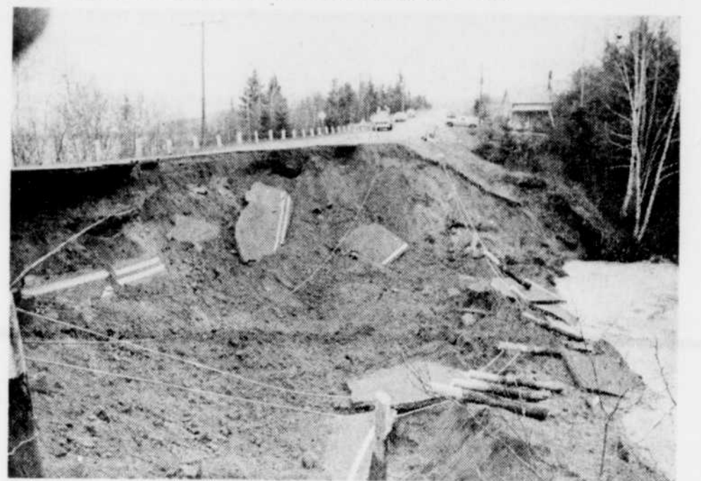
La route 19 s'est complètement effondrée sur une longueur de trente pieds à l'entrée du village du Lac-à-Beauce. Cet incident s'est ajouté au débordement de la rivière Saint-Maurice qui a bloqué la route 19 à divers endroits par des accumulations de quatre à cinq pieds d'eau sur la route. (Photo Gilles Berthiaume)
