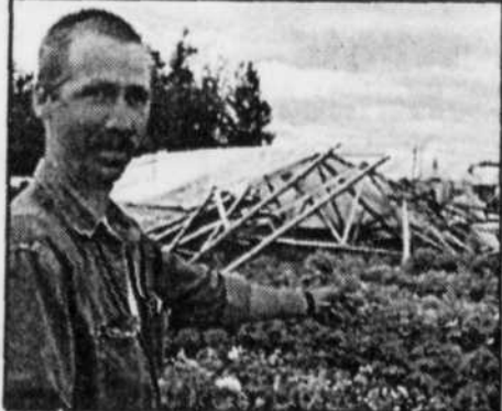
Marcel Cloutier, des Serres Roger Cloutier, à Bernières, se trouvait dans une serre avec une cliente lorsque le vent a littéralement soufflé la structure.
