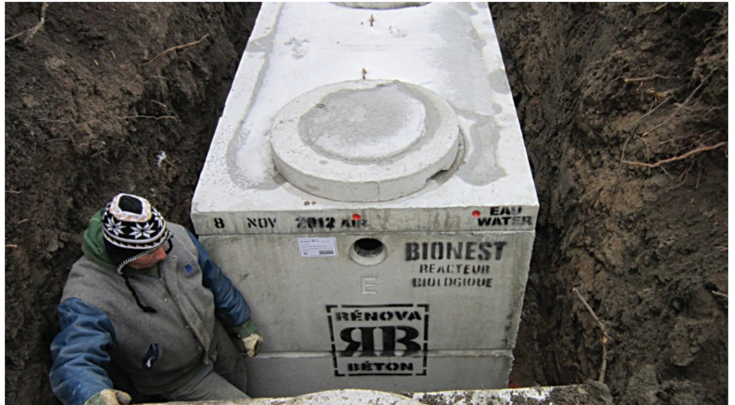
La durée de vie d'une fosse septique peut dépendre de plusieurs variables. (photo : courtoisie)
