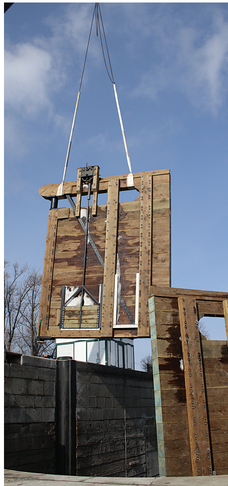
Les travaux sur le canal de Chambly débuteront à la fin du mois de février. (Photo : courtoisie)
