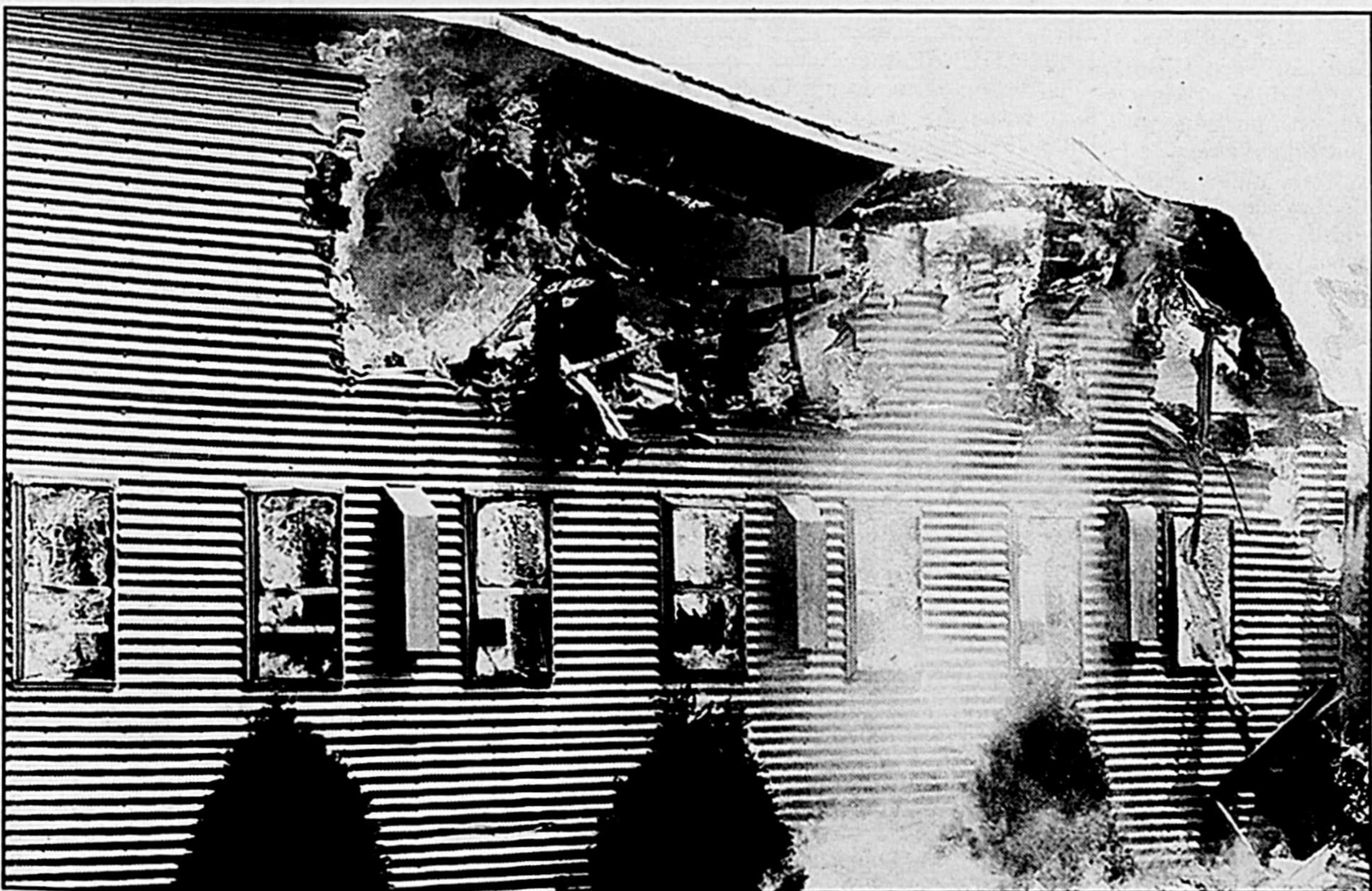
L'élément destructeur s'est propagé rapidement à toute la structure.
