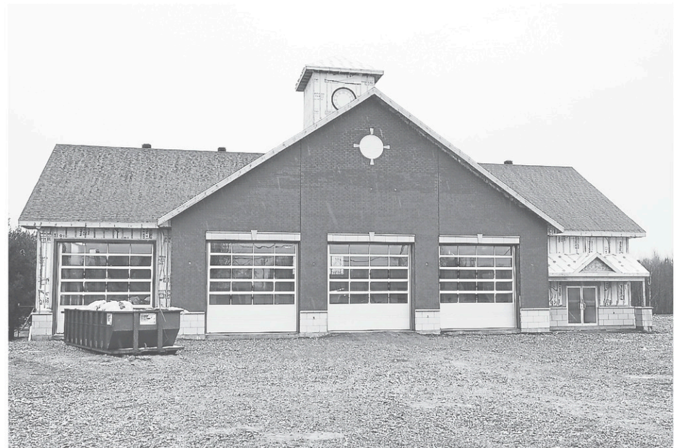
Ce n'est plus qu'une question de semaines avant que les pompiers de la municipalité de Sainte-Christine emménagent dans leur nouvelle caserne construite sur le chemin Béthanie. — PHOTO ALAIN DION
