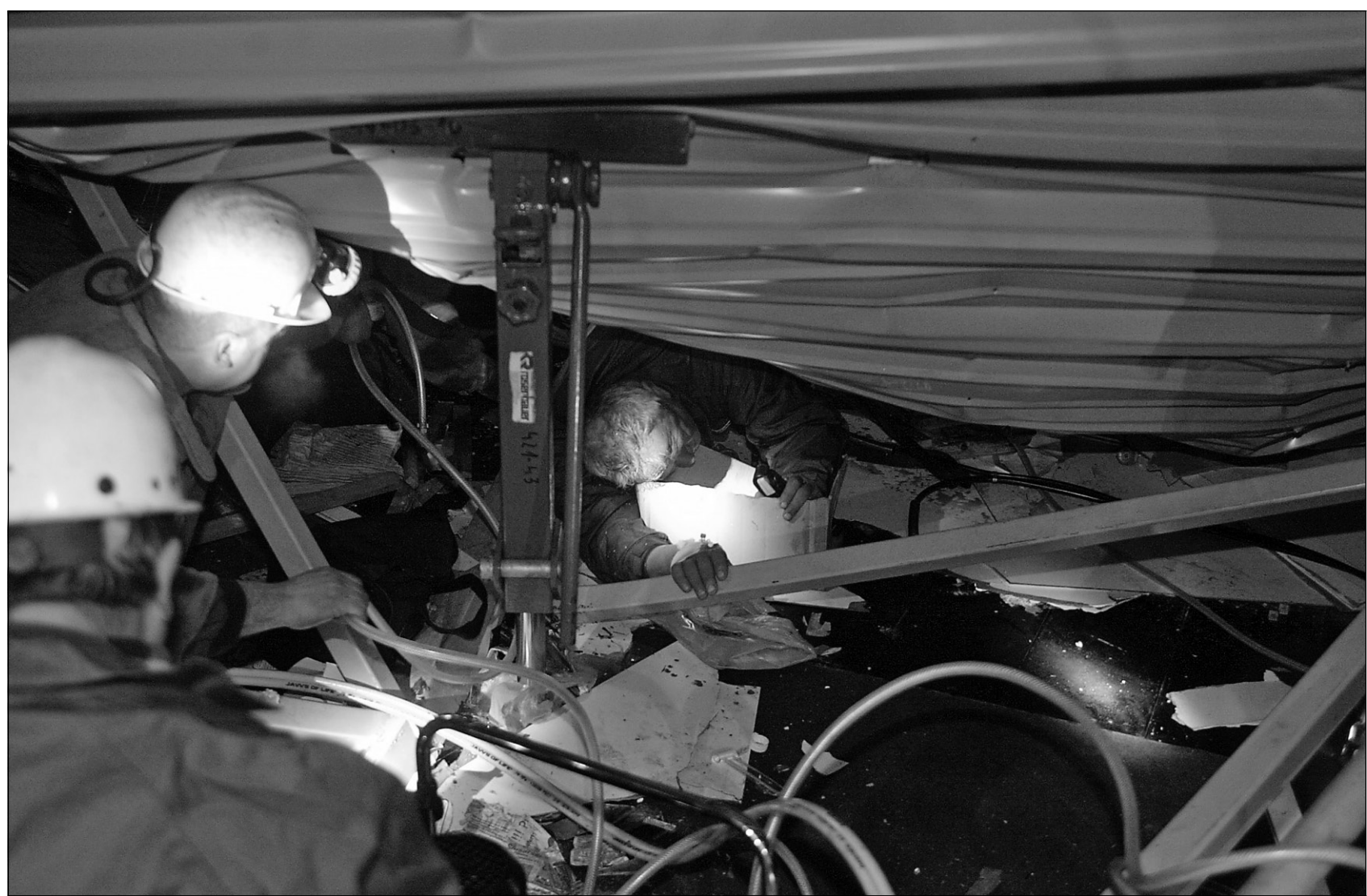
Des secouristes tentent désespérément de déloger un homme blessé dans l'effondrement du toit.
