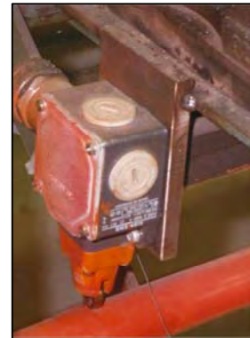
Protecteur désactivé (barrière abaissée)
