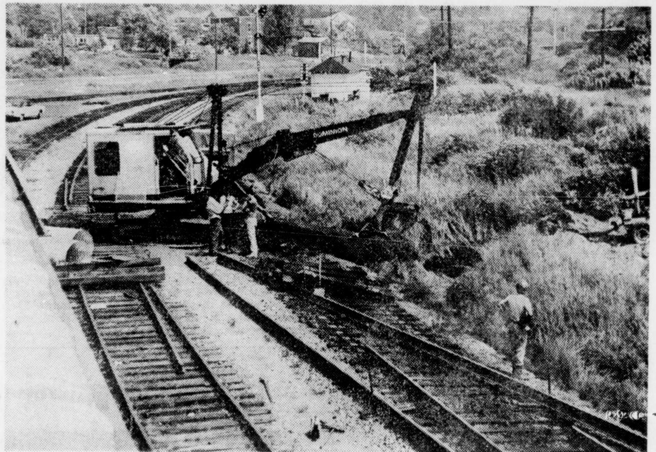
FRANCHIR LES RAILS DU CN, ce n'est pas une mince affaire! Pour installer la conduite d'eau qui desservira les Spécialités Laurentide Inc. les employés de la Voirie municipale de Grand'Mère ont dû traverser la voie fer-
