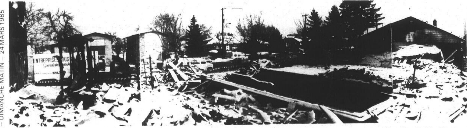
En décembre dernier, c'était la scène qui s'offrait à nos yeux au lendemain de l'explosion... Résultat? Trois maisons de la rue Poincaré pulvérisées, une quinzaine d'autres endommagées et, surtout, cinq personnes qui ont payé de leur vie l'affaissement meurtrier du sol.
