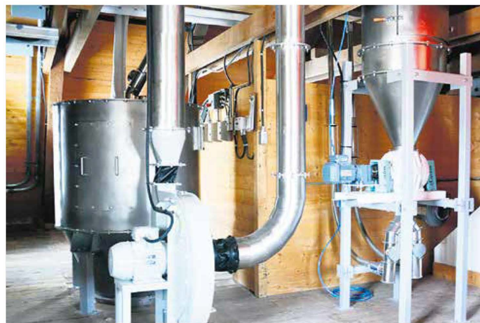
La plus grande partie de la machinerie a été installée dans le grenier du moulin, là où les visiteurs de la Seigneurie des Aulnaies ne vont jamais. Photo : Maxime Paradis
