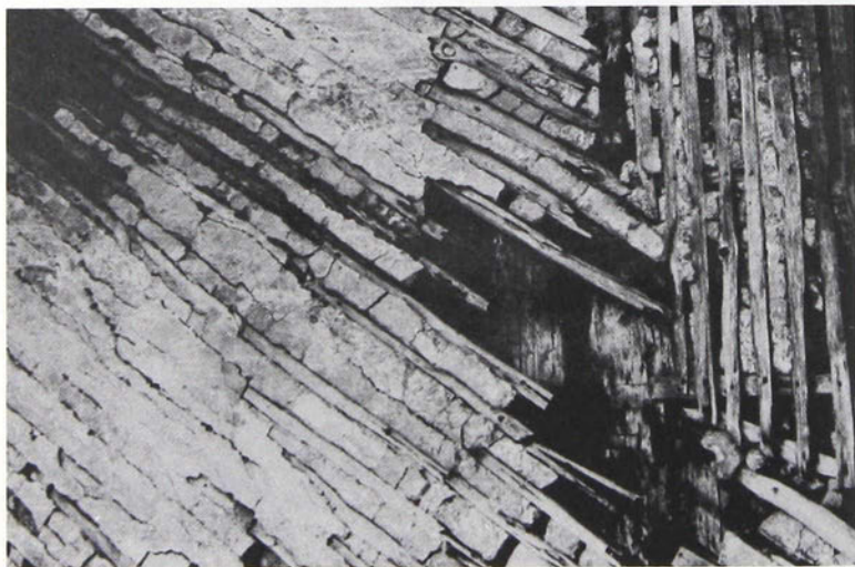
Sur ce mur extérieur, la dégradation de l'enduit laisse apparaître le lattage.
