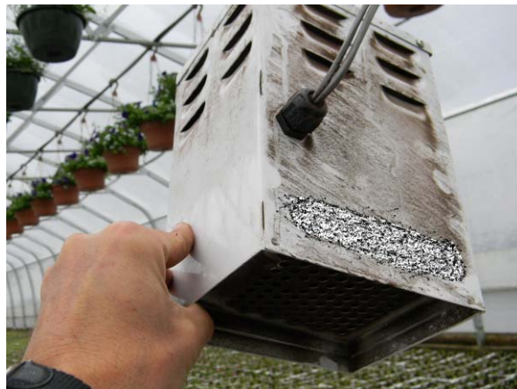
Photo 2 : Cage de sonde climatique à nettoyer.
