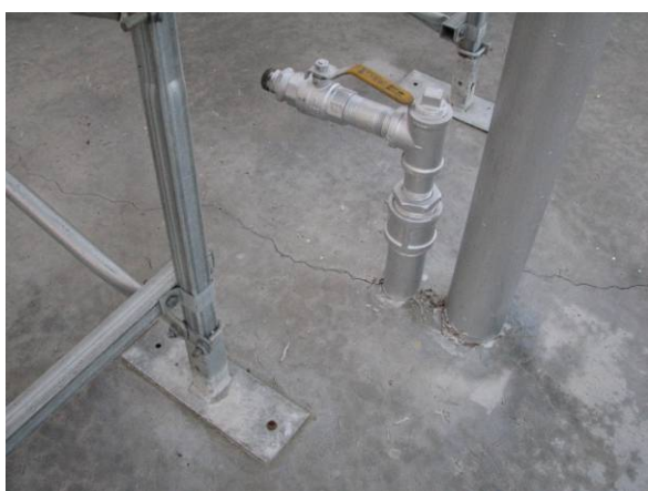
Photo 3 : Pied de table, poteau de serre et sortie d'eau bien nettoyés et désinfectés.
