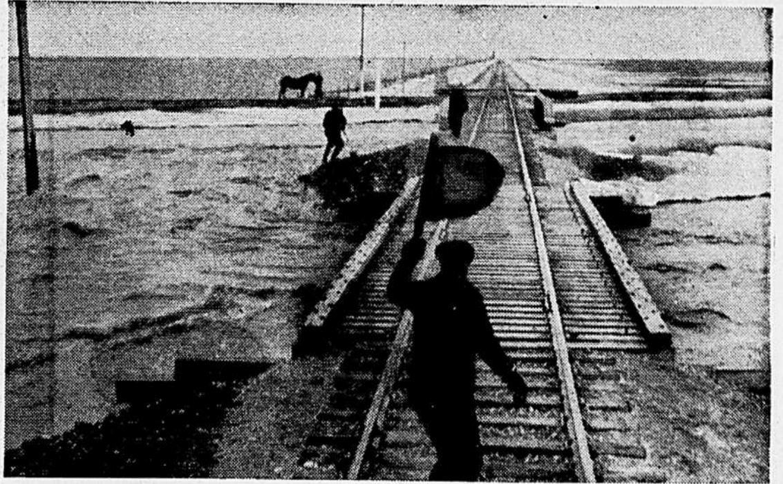
LA LUTTE CONTRE L'INONDATION. — Des ouvriers luttent sans répit contre le courant qui menace de destruction le pont du CPR, à cinq milles au nord de Rosenfeld. A Selkirk, à 25 milles au nord de Winnipeg, l'eau s'étend à perte de vue. Les habitants ne circulent plus qu'en barque et les blocs de glace ont brisé et emporté les lignes téléphoniques.
