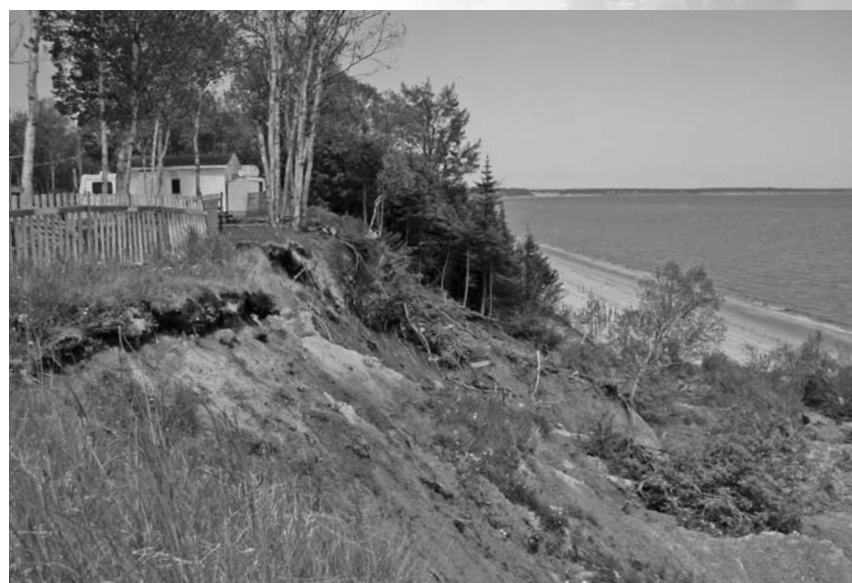
Effets combinés de sapements et de mouvements de masse au pied d'une maison sur la Côte-Nord.
