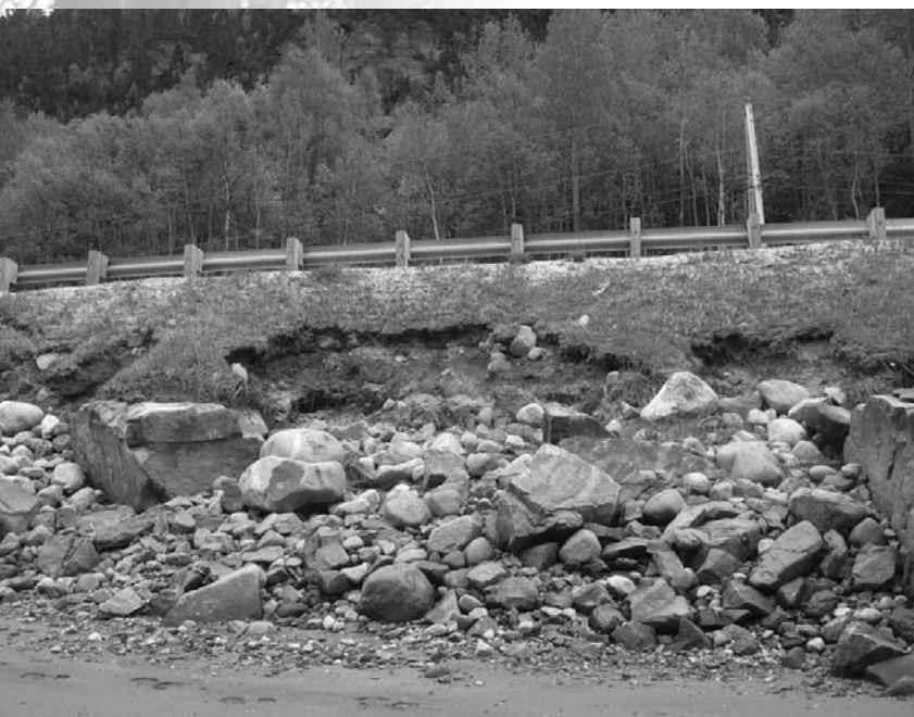
Érosion menaçant la base du talus de la route 138. Les ouvrages existants d'enrochement ont leurs limites comme solution, surtout dans le contexte des changements climatiques.
