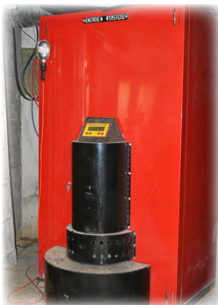
La chaudière à biomasse du Pavillon de l'Académie de l'Assomption
