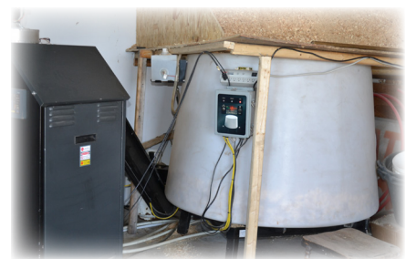
Chaudière et réserve
