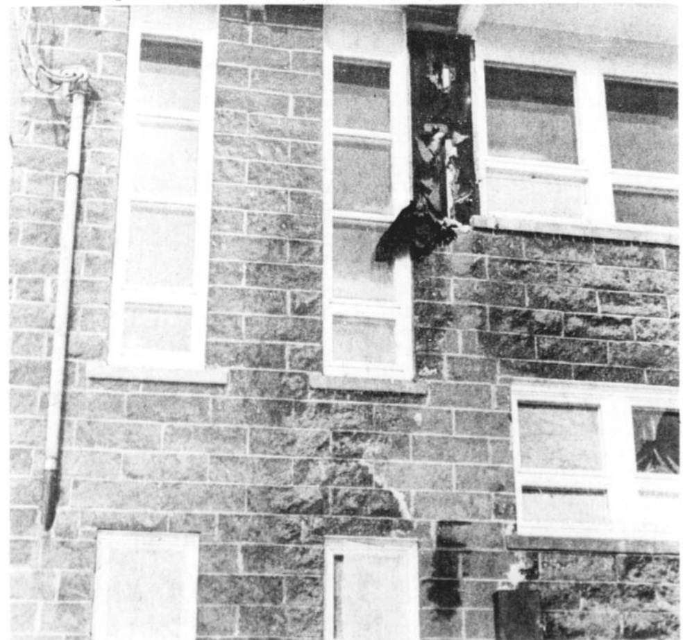
DEGATS EXTERIEURS — A l'extérieur de l'école, les dégâts ne sont pas élevés.
